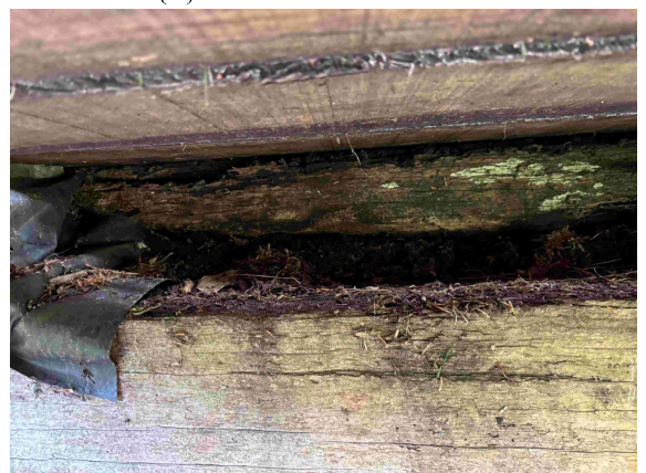
2025 WIDERLAGER KANTHOLZ VERFAULT
