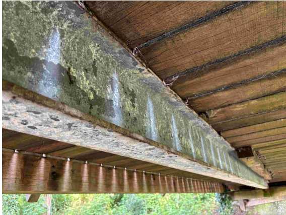
2025 LÄNGSTRÄGER KORROSION MITTELFELD
