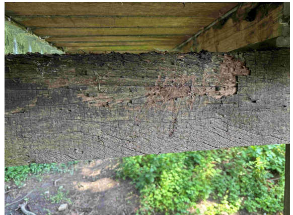
2025 BRAUNFÄULE MIT WÜRFELBRUCH AN DEN BALKEN
