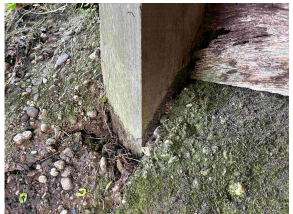
2025 WIDERLAGER RAMMPFAHL VERMODERT IN WASSERWECHSELZONE
