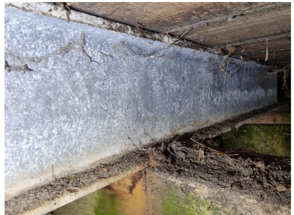
LÄNGSTRÄGER MITTELFELD LAGESICHERUNG KORROSION
