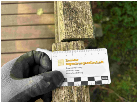
2025 GELÄNDER ERHÖHUNG VERKIPPT
