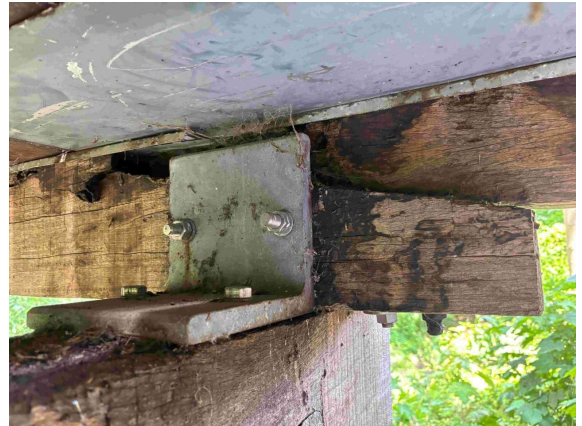
2025 LÄNGSTRÄGER PILZBEFALL & QUERSCHNITTSCHWÄCHUNG
