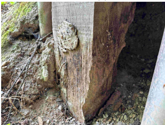
2025 PILZBEFALL AM RAMMPFAHL
