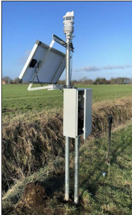
Bild 2: Neu installierte Wetterstation
