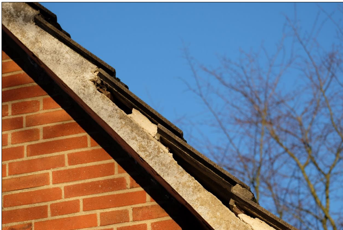
Abb. 16: Lücken an den Ortgängen des Nebengebäudes
