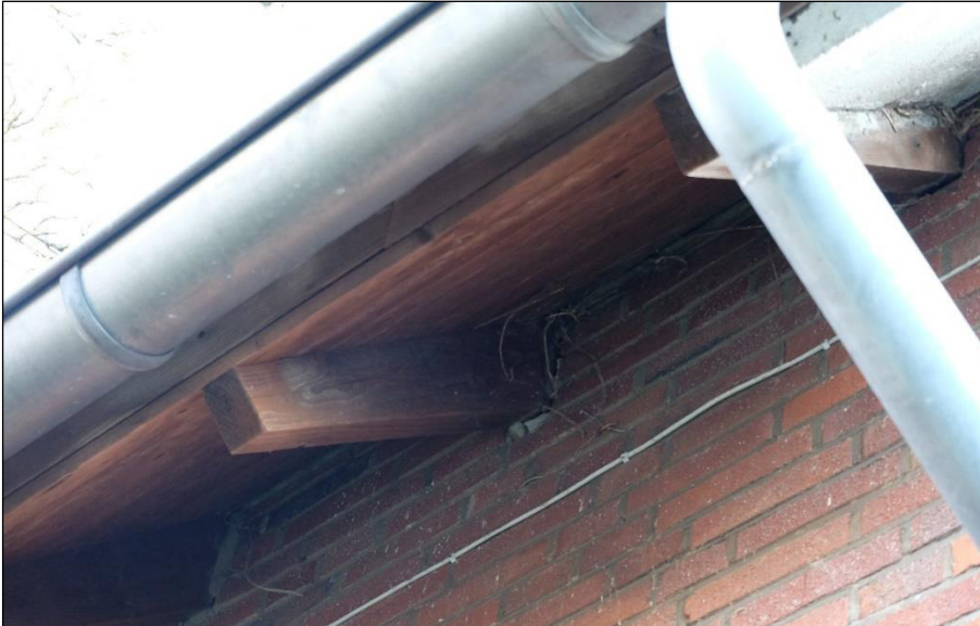
Abb. 6: Kotpuren an der Fassade in Traufbereich; Westseite des Wohngebäudes
