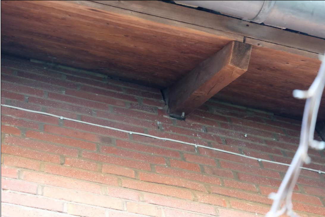
Abb. 11: Spalten zwischen Hauswand und Dachbalken; Westseite des Wohnhauses
