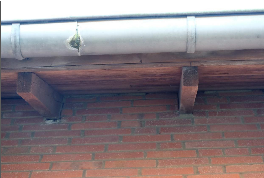
Abb. 10: Spalten im Traufbereich; Westseite des Wohnhauses
