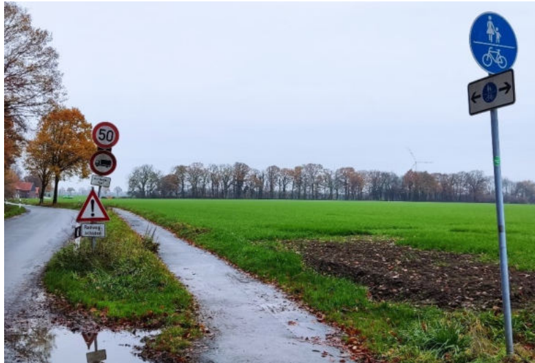
Abbildung 57: Defizitäre Oberflächenqualität eines Radwegs in Nottuln
